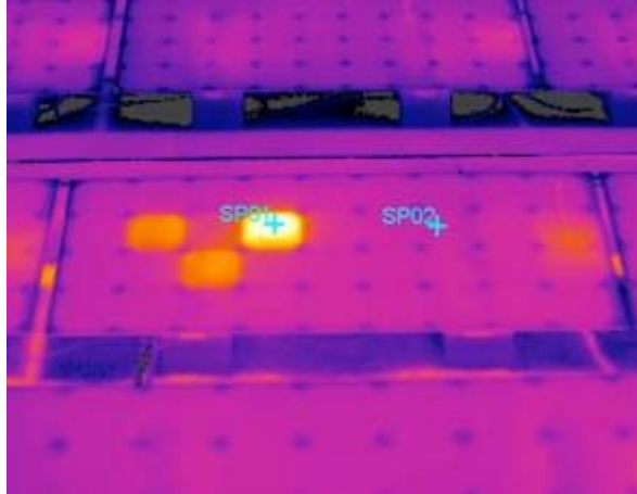
Punti caldi in un modulo fotovoltaico (celle surriscaldate o hot spot)
